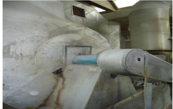
↑ Kağıt Fabrikası Yanma Hava Ünitesi
