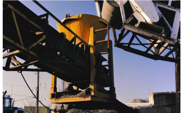
↑ Taşocağı Konveyör Tambur Ünitesi
